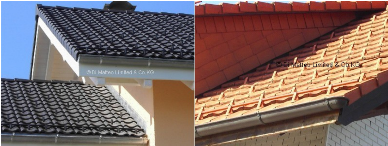
Beispiel: 2 Dächer eingedeckt mit Schneestopfnasen und ZMS-Rohrsystem (unterste Reihe)
